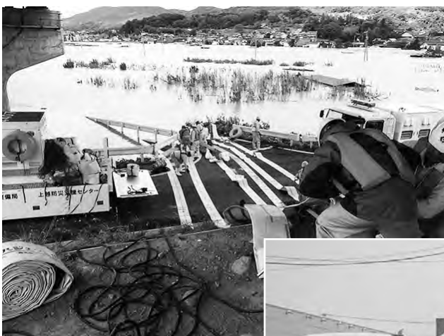
昨年の台風19号で千曲川の堤防が破堤し、甚大な被害を受けた長野県。いち早く現地に向かい、復旧に当たったのも上越地域の建設業者だった（2019年10月）
